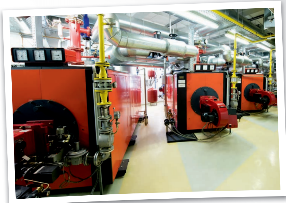
Kesselanlage Ossendorfspark, Köln
