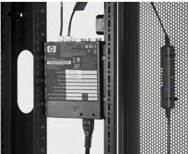
DSC-Steuerungsgerät im Rack
