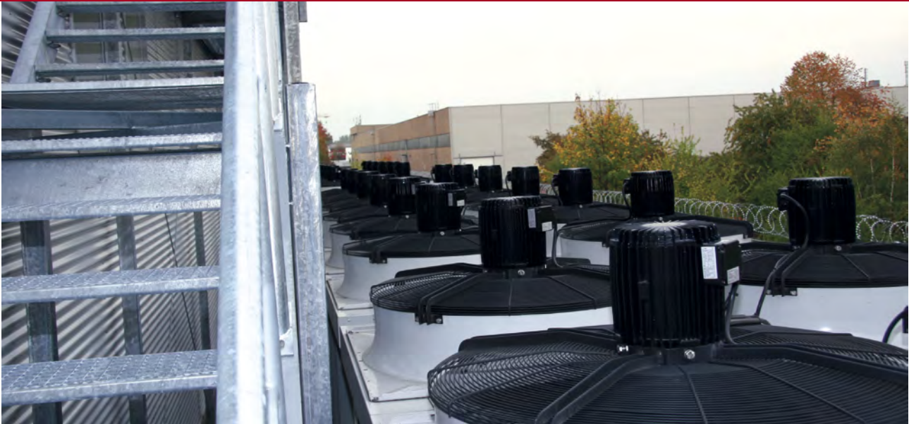
Rückkühler im Schatten des Gebäudes
